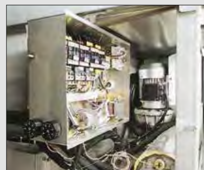
Cuadro eléctrico LP-67
