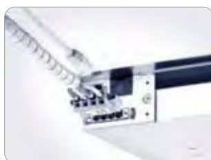
Conexión enchufe generador
